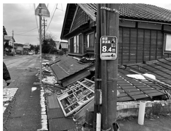
倒壊している建物も調査
