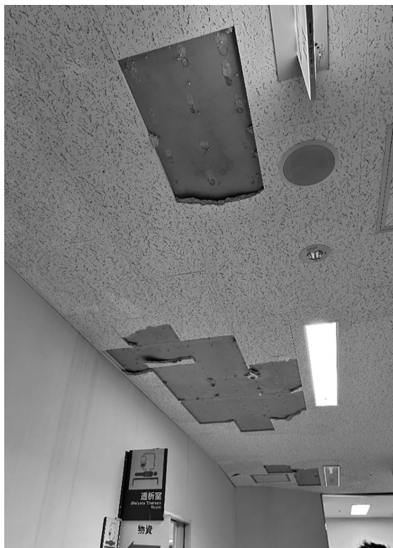
透析室前廊下の天井
